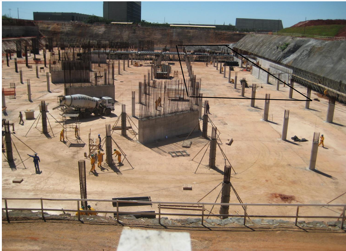
Foto 12 – Concreto Pilares 3º subsolo, trecho V entre os eixos 11 e 13, ref. Item 03.02.700 no Memorial descritivo
